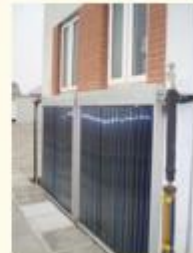
太阳能 建筑 一体化 实验 室
